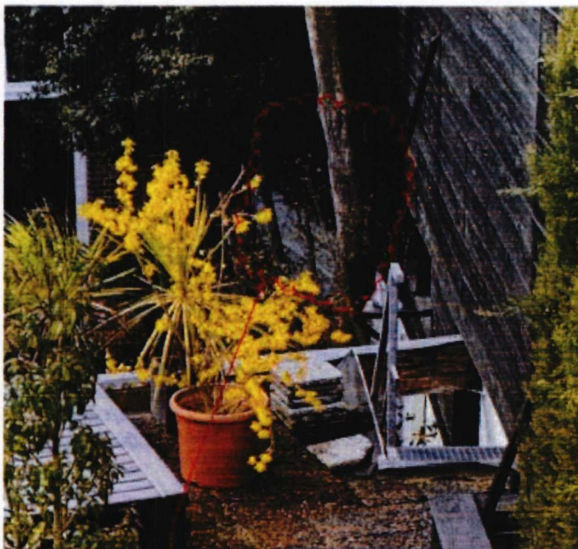
Bestaand raamkozijn buren voor ruim 50% weggelimmerd
